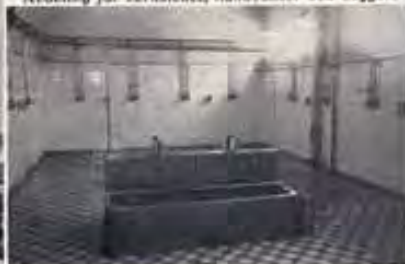
På gulvet Jøtulstøker i rustfritt stål. Duerjer med temperaturregulert varmt vann, 39° C.
